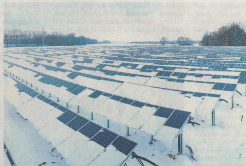
Über Kilometer ziehen sich die Modulreihen über das tief verschneite Areal am Stadtrand.
